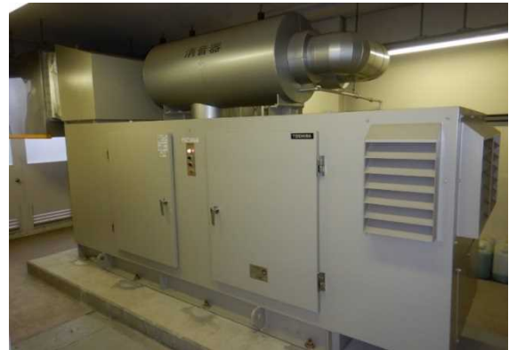
自家発電設備
