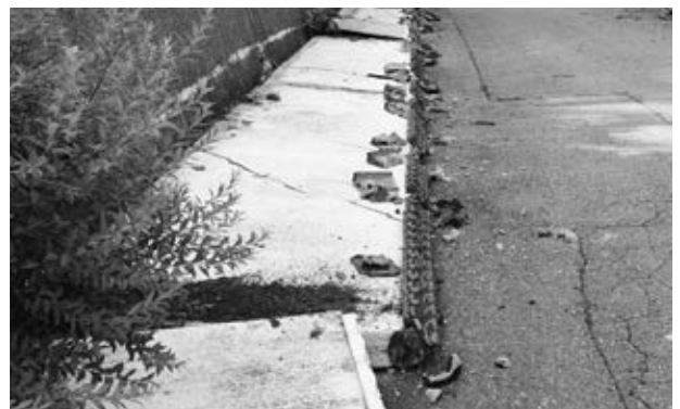
▲昨年6月に発生した地震により鶴岡市内で倒壊したブロック塀
